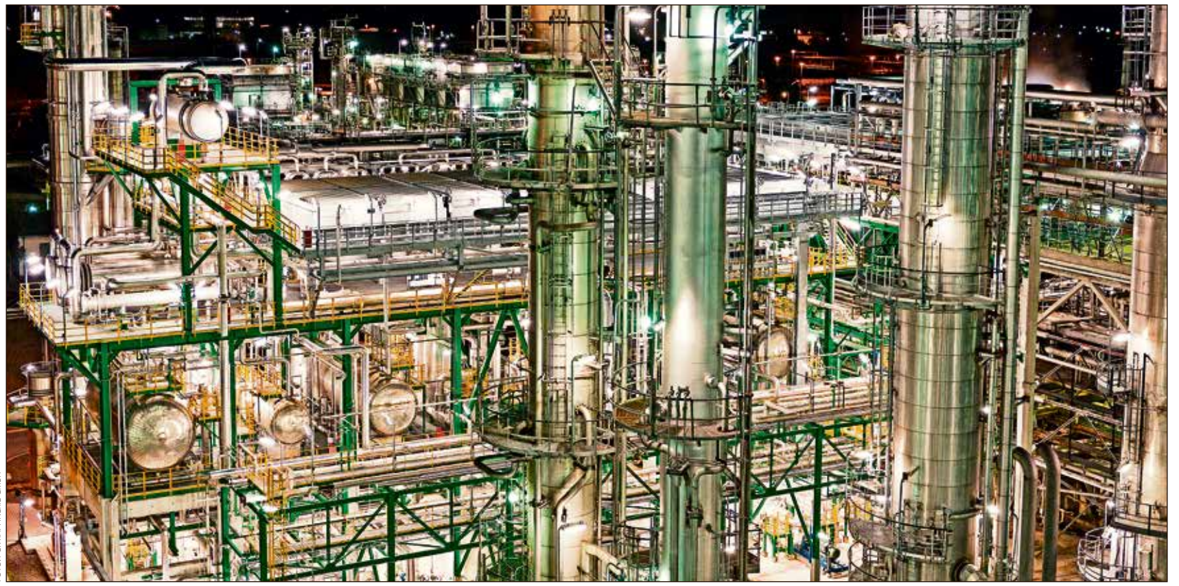
PCK-Raffinerie in Schwedt/Oder: Seit 55 Jahren wird hier russisches Erdöl zu petrochemischen Produkten und Kraftstoffen verarbeitet
